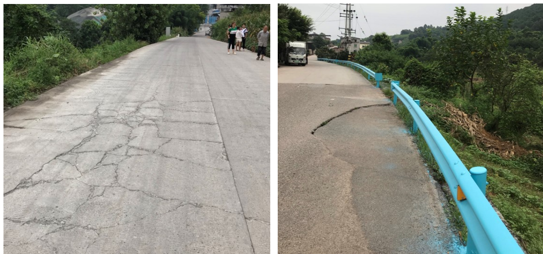
水泥混凝土路面病害现状图
