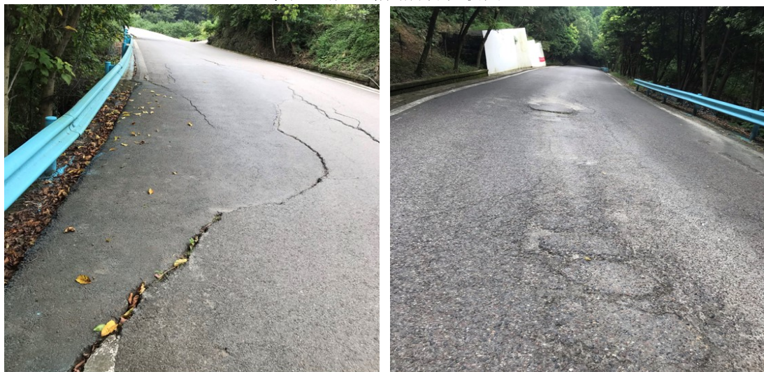
沥青混凝土路面病害现状图
