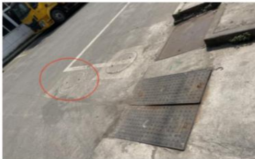
依托的厂区现有生化池
